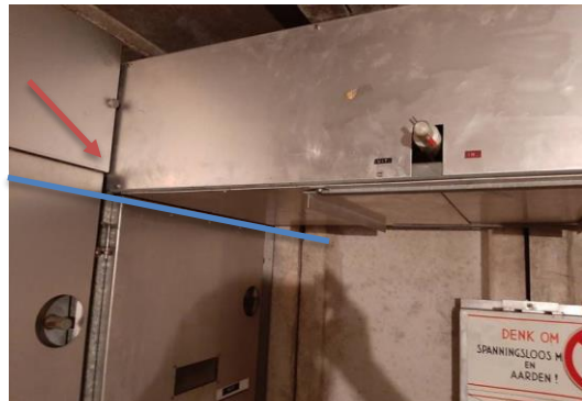
Foto 3. Nieuw type Prefab Brug/zekeringveld
