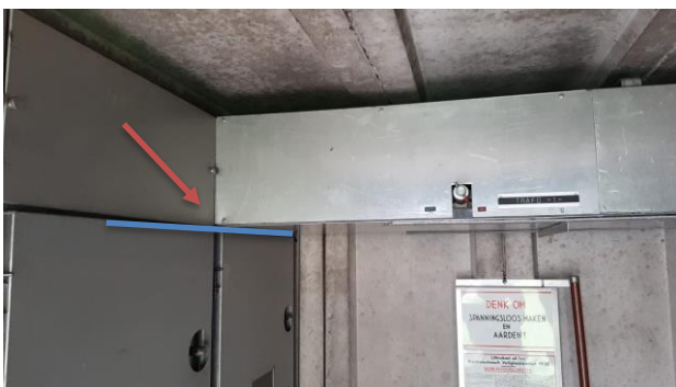
Foto 2. Oud type Prefab Brug/zekeringveld
